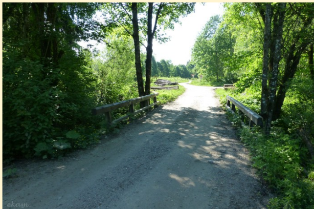
Kurz vor dem Bahngleis läuft der Bach unter Straße hindurch
